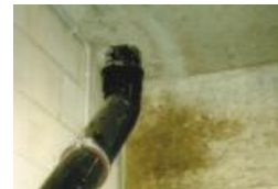
Aussenwand mit Feuchtigkeit und Schimmel
